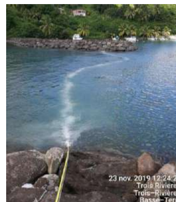
Figure 94 : Illustration de la mise en œuvre d'une barrière anti-MES sous forme d'un rideau de bulles (source : CREOCEAN, 2019)
