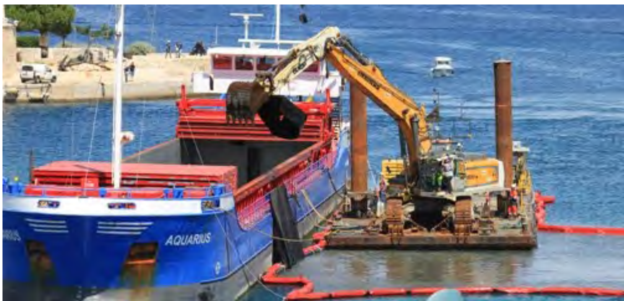
Figure 3-4 : Illustration d'un atelier de dragage en mer avec une barrière anti-MES (source : www.tramar.fr )
